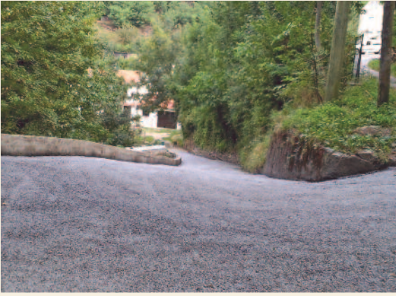
Réfection de l'impasse du Patus à St Baudille suite aux inondations du 30 mai 2013.
